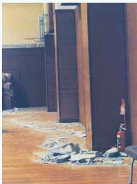
体育館被災状況
