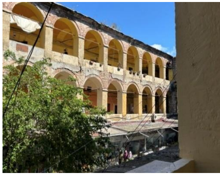
写真3: Büyük Yeni Han: 中庭回廊部分までの店舗の拡張や、崩れ落ちた壁面でのセメントによる補修(筆者撮影)
